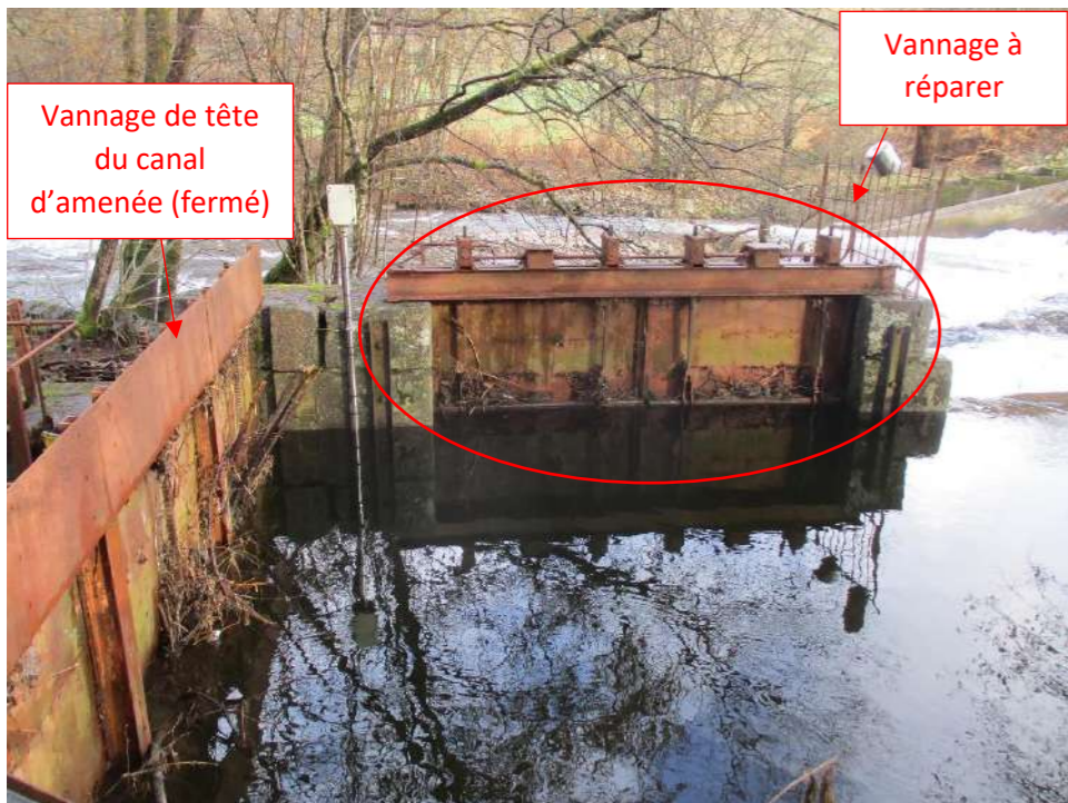
4. Vannage de décharge à réparer (Vue vers l'aval – depuis la rive gauche)
