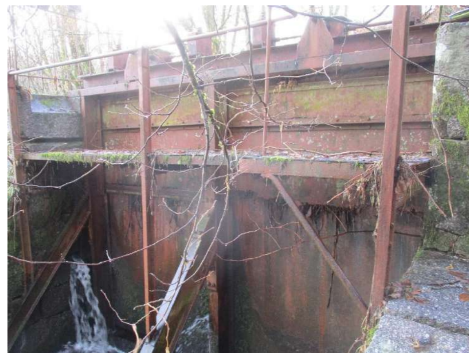
5. Vue aval du vannage de décharge à réparer (Vue depuis l'aval)
